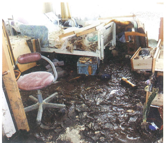
仙台市若林区の特別養護老人ホーム「杜の里」。利用者の終ついの棲家であるはずだった部屋は、黒い汚泥で飲み込まれていた。
