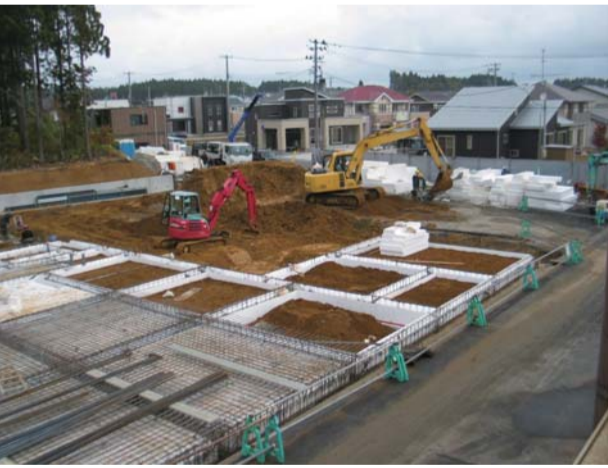
金谷地区11月上旬の工事風景。建築の基礎となるコンクリートを枠内に流し込む打設工事をしています。
