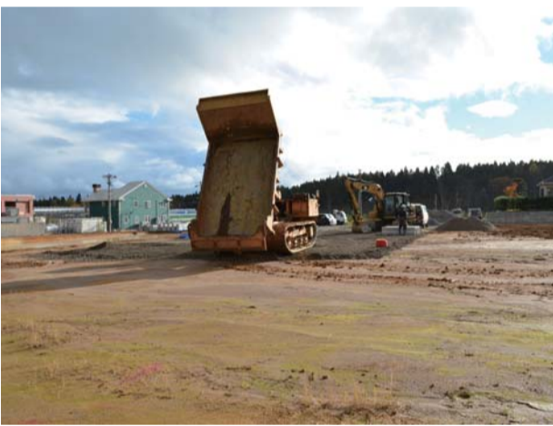
十二林地区の工事風景。11月に工事開始、側溝工事に取リかかっています。
